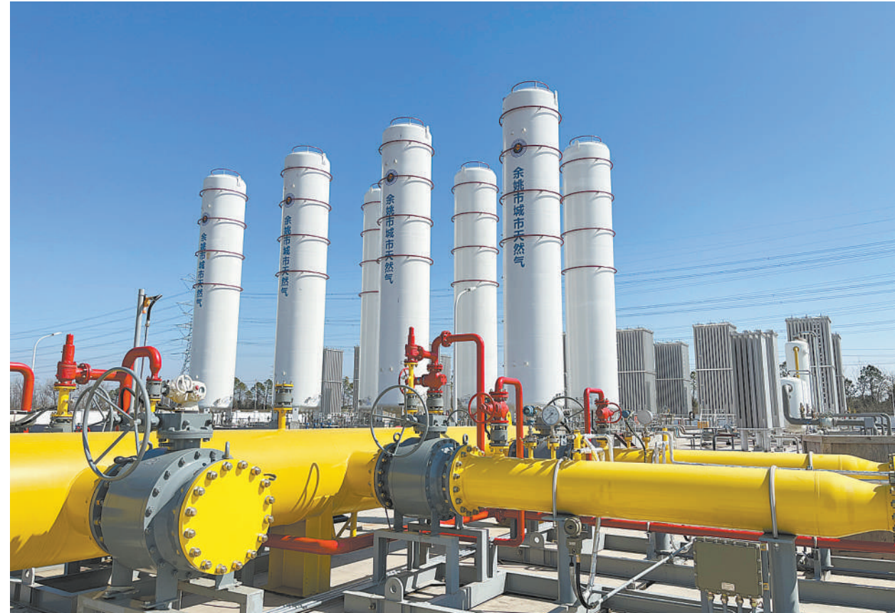
图为LNG应急气源站。
