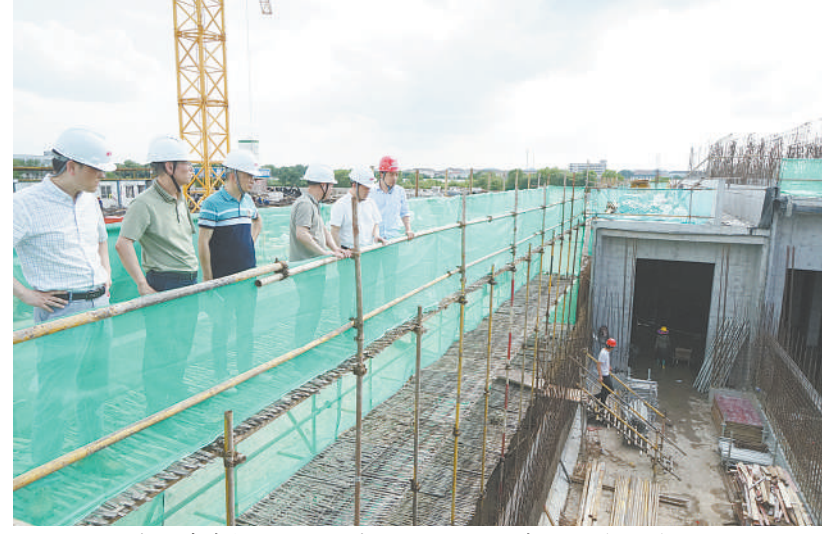
近日,宁波舜建集团组织人员对姚北水厂新建工程(一期)施工现场进行安全生产专项检查。 通讯员 黄珊摄
